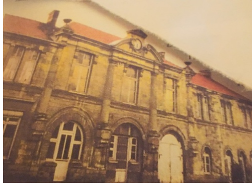
Les communs fortement dégradés
